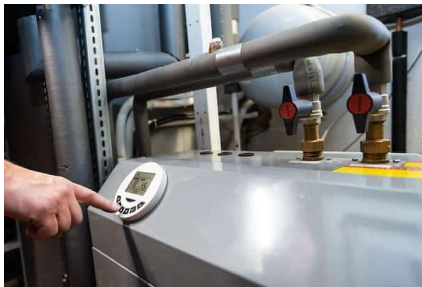
Wärmepumpe im Keller eines Wohnhauses
